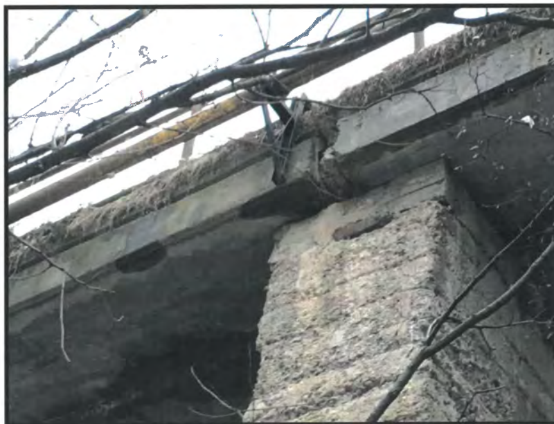
Foto nr. 2 – Solidarizare necorespunzatoare intre fasiile cu goluri, latime insuficienta a banchetei de rezemare. Fasiile marginale nu reazema pe toata latimea lor.
