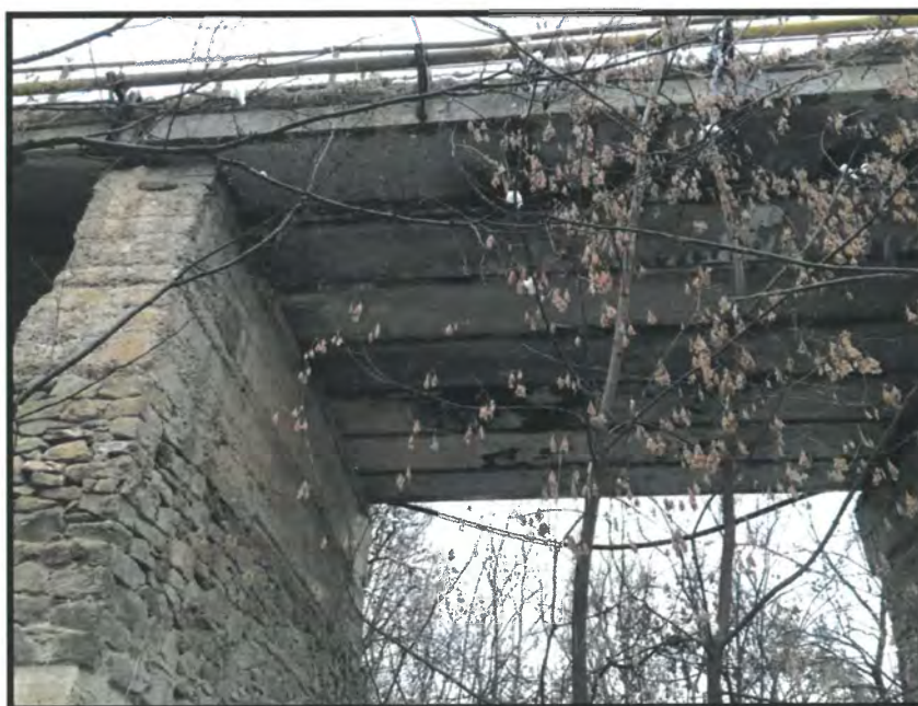
Foto nr. 3 - Construcția defectuoasă a banchetelor de rezemare cu lățime insuficientă, fără spații de vizitare
