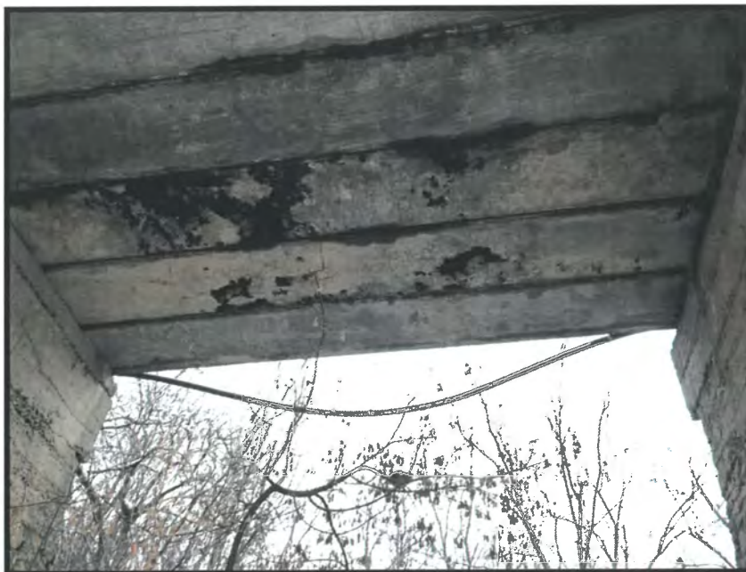
Foto nr. 1 - Coroziunea armăturii, pete de rugină la nivelul tălpii inferioare a fâșiilor cu goluri prefabricate
