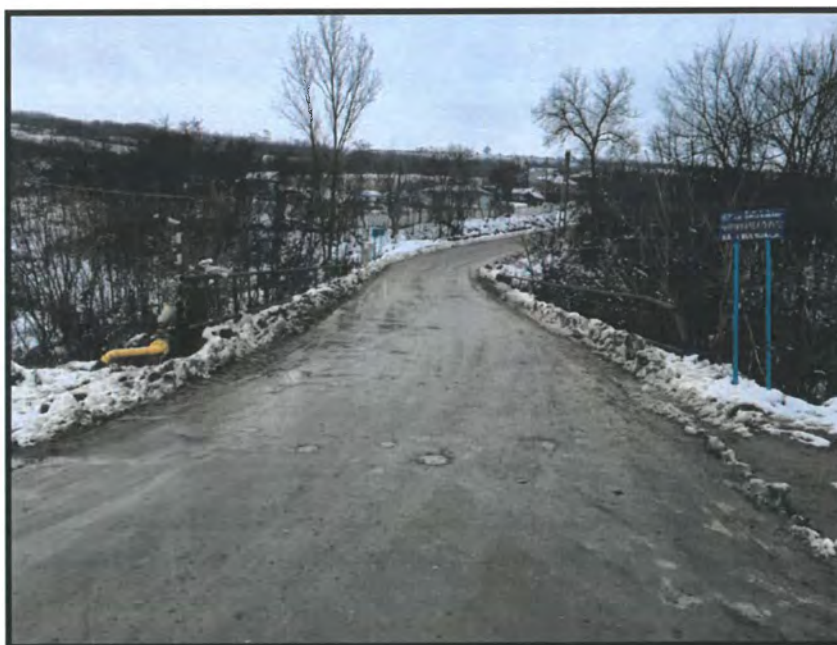
Foto nr. 4 – Alinierea rampa pod defectuoasa, acces dificil pe pod, lipsa parapetului directional
